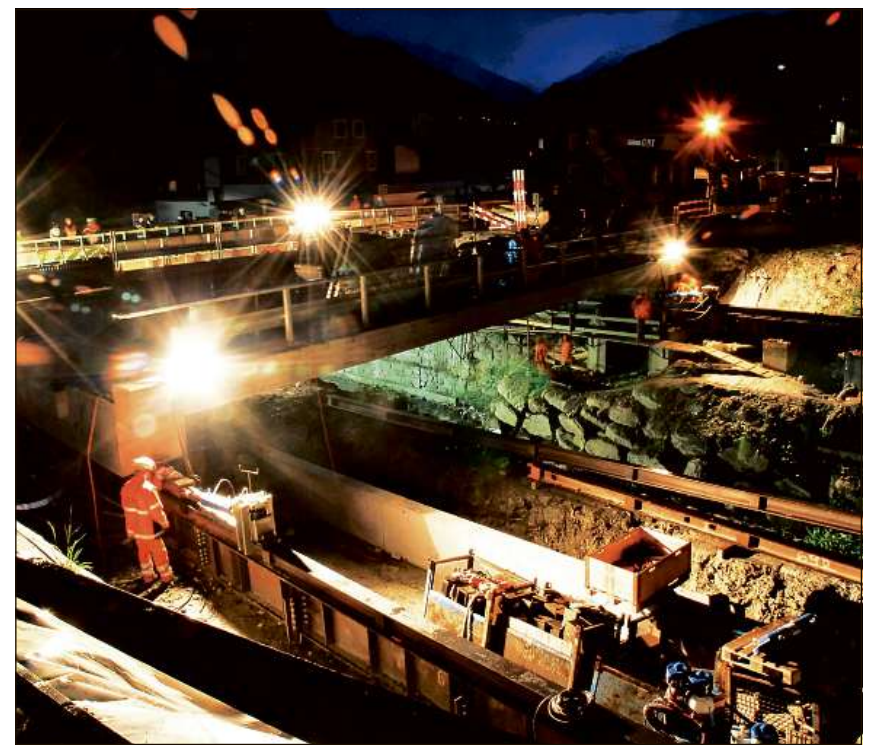
La platta da 600 tonnas semova mintgamai 80 centimeters alla gada. Seniester (cun luvrier) vesan ins la pressa idraulica. Da mintga vart stauscha ella 300 tonnas.
